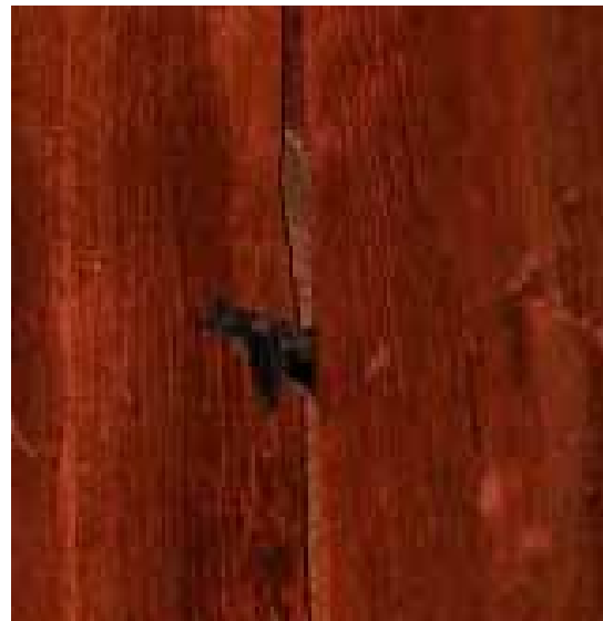
Kuva 6. Lepakko ryömii hirsitalon seinälautojen kapeasta (n 1 cm) raosta sisään. (Kuva: Malin Tverin)
